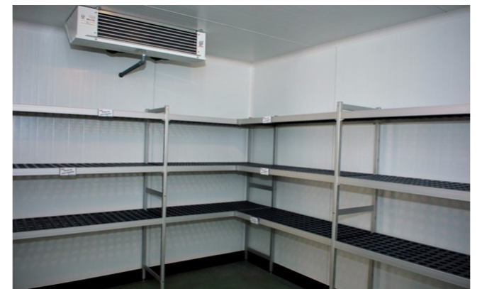
Intérieur chambre froide
